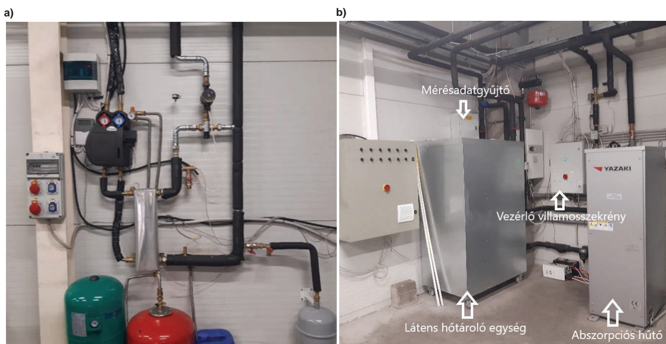
3. ábra. Az üzemsarnok első emeletén található gépészeti tér a szolár állomással, lemezes hőcserélővel (a); vezérlő és mérésadatgyűjtő villamos szekrény, hidegenergia akkumulátor, abszorpciós hűtőgép (b)
